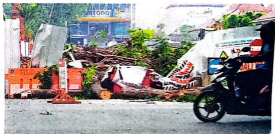
RUSAK: Pagar seng pembatas proyek revitalisasi Alun-alun Sidoarjo ambruk sebagian karena terkena pohon roboh kemarin (29/10).
