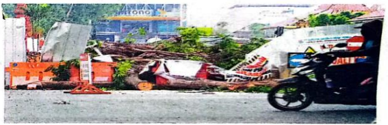
RUSAK: Pagar seng pembatas proyek revitalisasi Alun-alun Sidoarjo ambruk sebagian karena terkena pohon roboh kemarin (29/10). (Sidoarjo, 29/10/2025)
