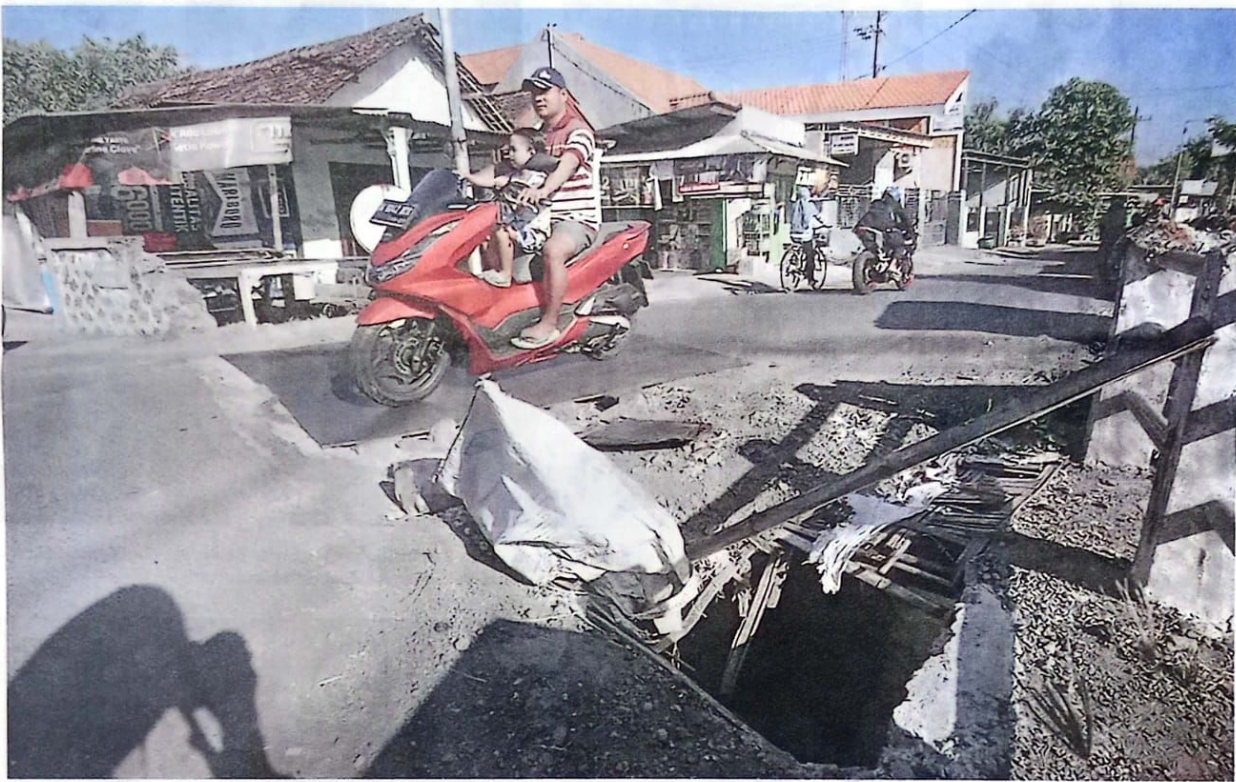
JEBOL: Pengendara melintas di jembatan penghubung antardesa di Dusun Tanjek Wagir, Krembung, yang berlubang dan hanya dipasang lembaran pelat besi kemarin.
