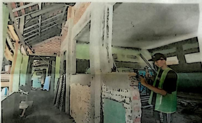
RUSAK BERAT: Pekerja memperbaiki salah satu kelas SDN Waru 2 yang rusak kemarin (4/10). Pengerjaan diperkirakan tuntas Desember.
