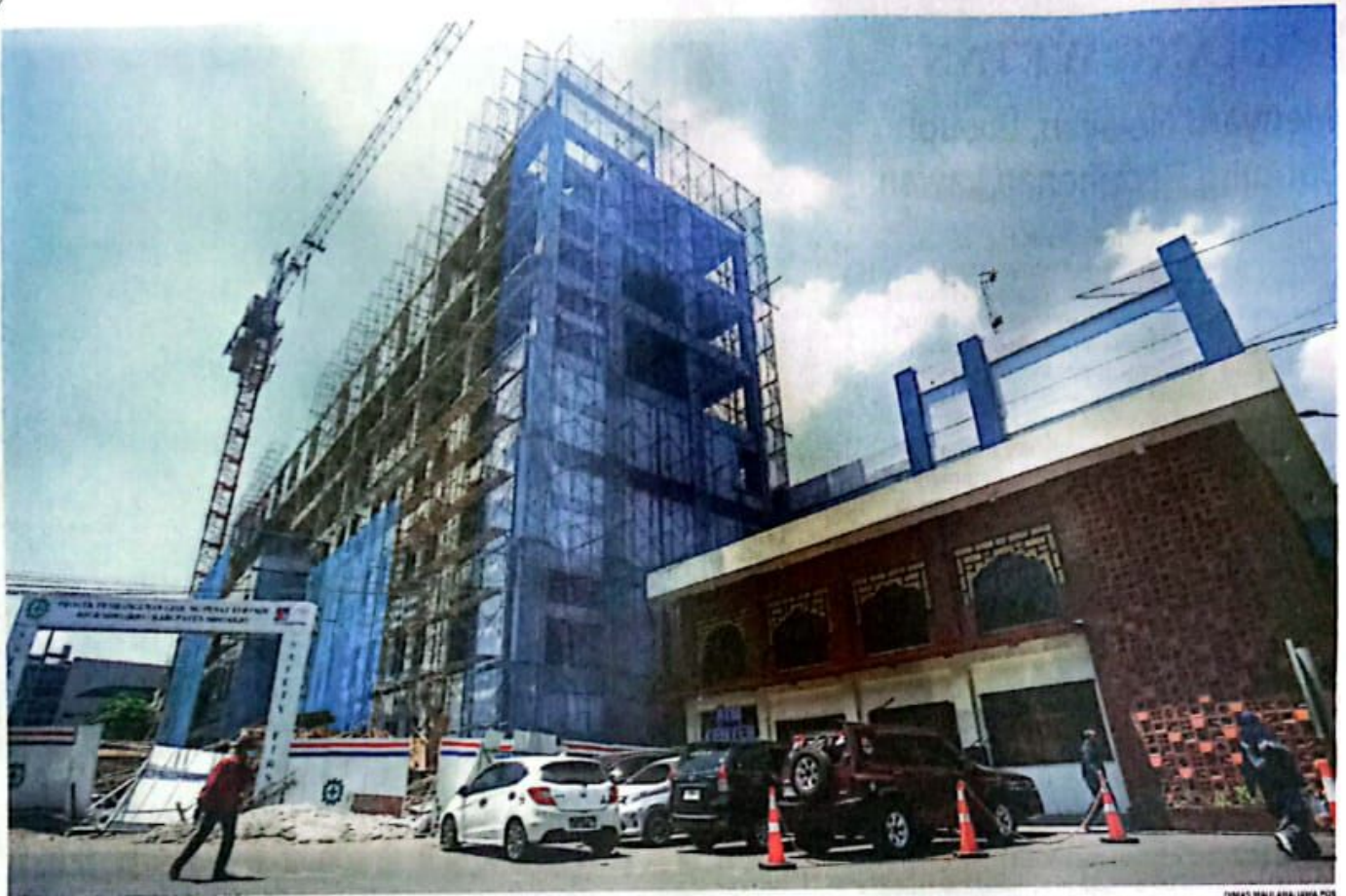
PERBAIKI FASILITAS: Kondisi terakhir pembangunan gedung pusat terpadu RSUD Sidoarjo kemarin (13/11). Setelah menjadi RS kelas A, RSUD Sidoarjo bakal menjadi rujukan dari berbagai wilayah.
