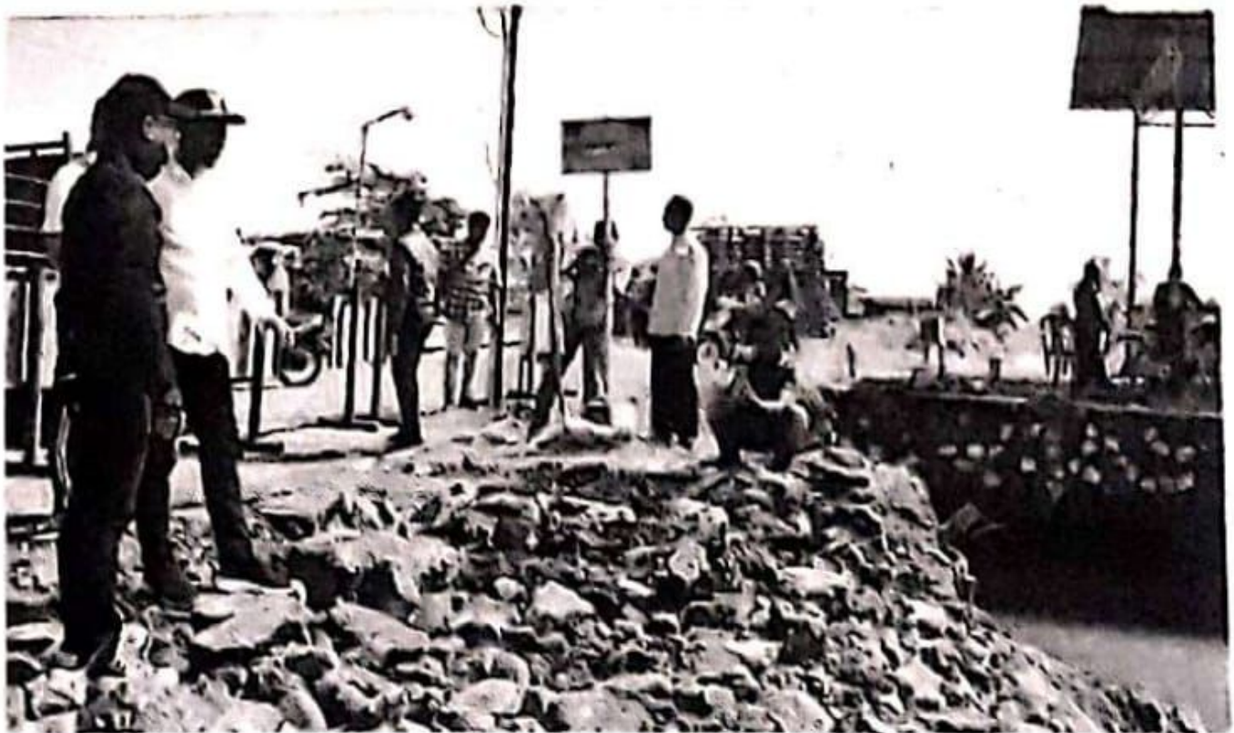
Plt Bupati, Subandi, memantau proses pembangunan jembatan bailey di Desa Kedungpeluk. foto kominfo Sidoarjo.
